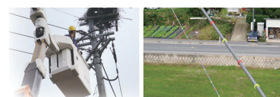
電柱に巣をつくるコウノトリ
